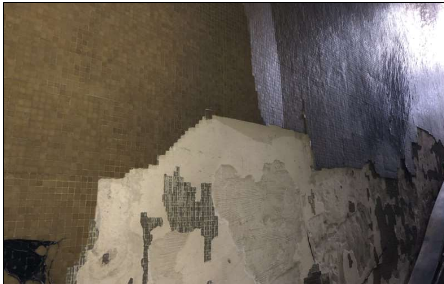
Foto nivel vestíbulo – Estado de muros laterales de E.M. N°2
