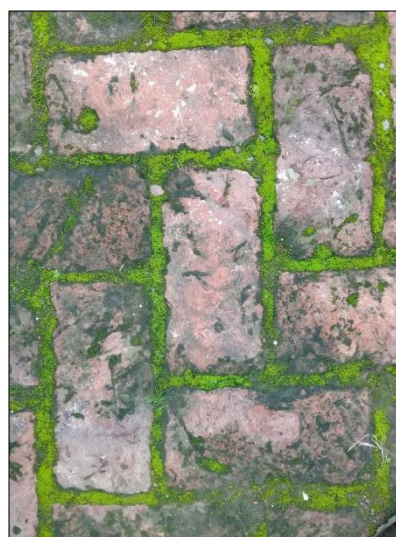
Detalle del camino de ladrillos. Las sombras, el fresco y la humedad hacen que en varios sectores reaparezca el musgo (que no está inventariado) casi cotidianamente en las épocas frías. El sol de la mañana hace ver la belleza de su color.
