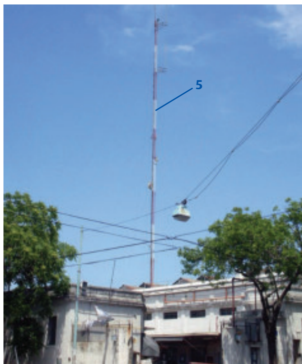
Torre de microondas de EDESUR. (NZ)
