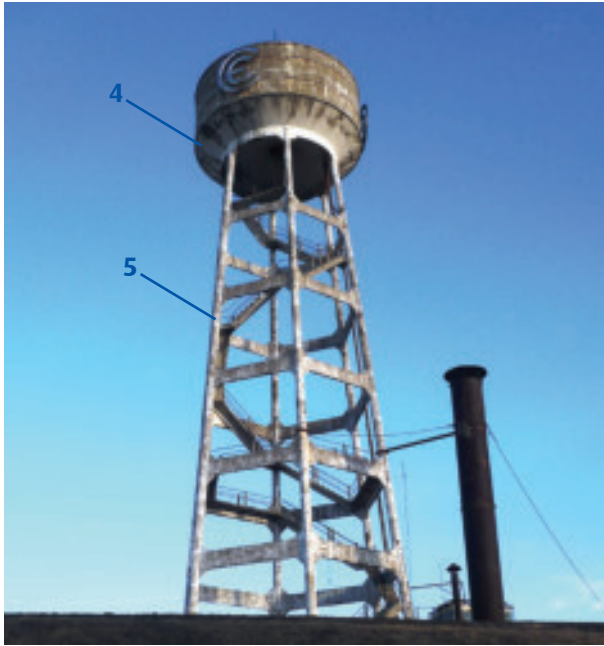
Tanque de reserva, empresa Metalúrgica Centenera. (LC)
