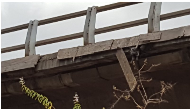
Maderas en peligro de caída. (Autopista)
