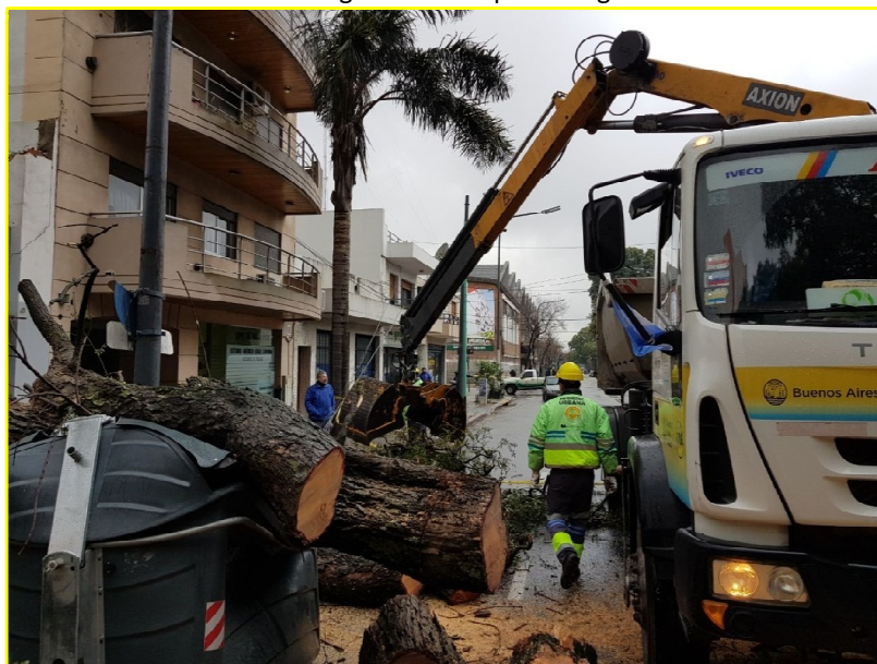
Emergencia Av. Lope de Vega
