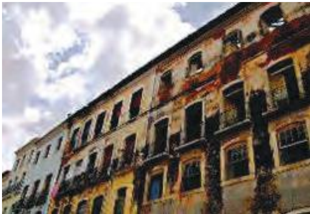
FALTA DE MANTENIMIENTO DE LOS INMUEBLES HISTÓRICOS
