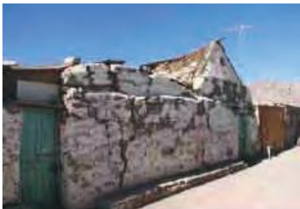
SITUACIÓN LUEGO DEL TERREMOTO DE 2005
