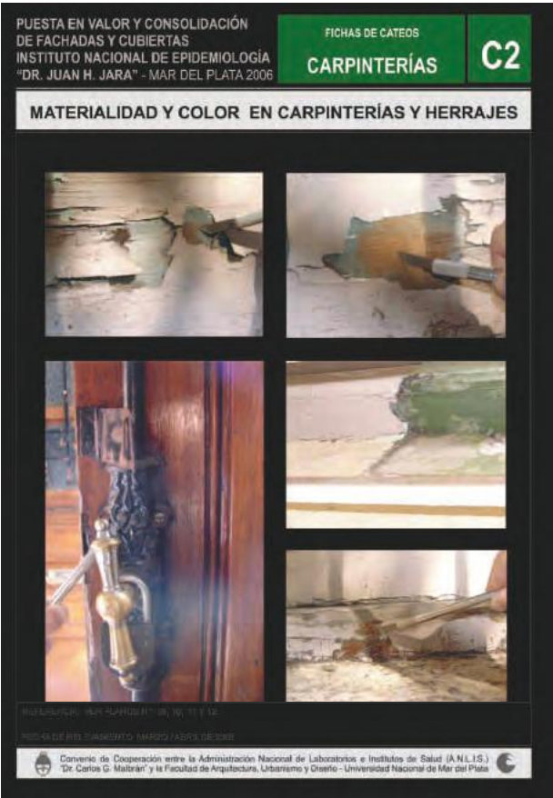
RELEVAMIENTO DE DETERIOROS
