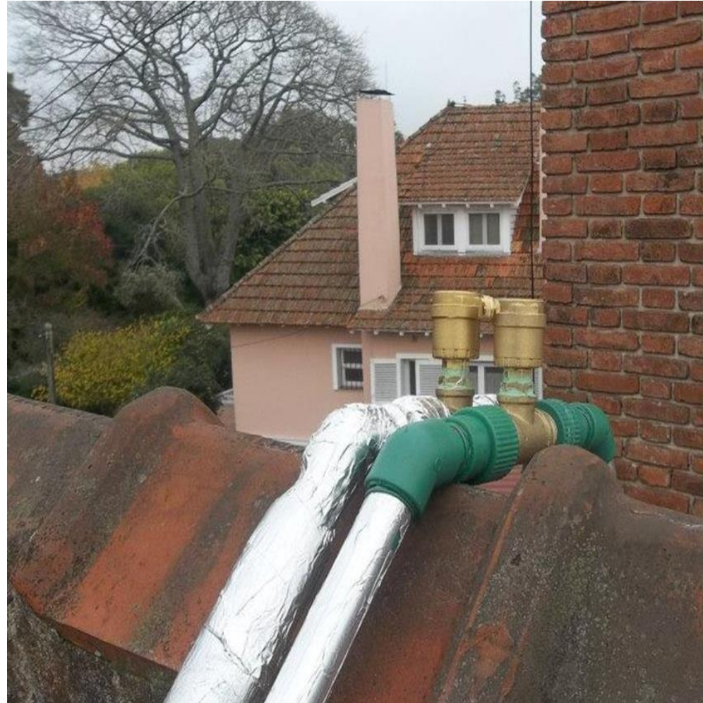
Válvulas de purgas de aire
