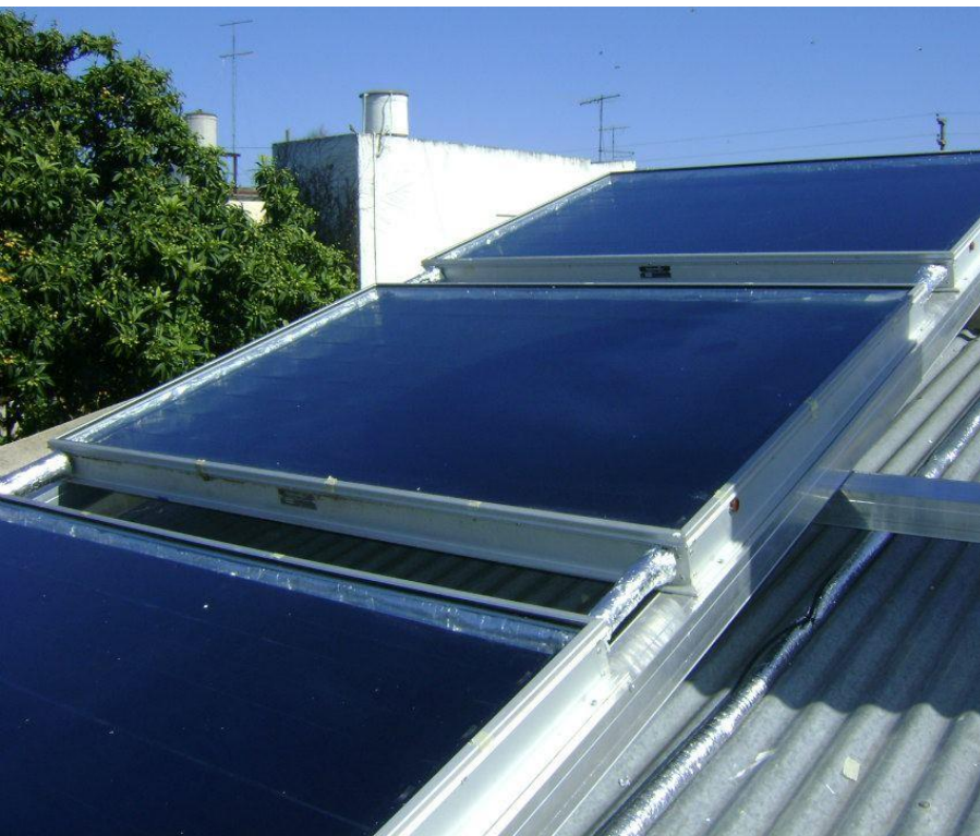
Climatización piscina – circulación forzada – Los Hornos
