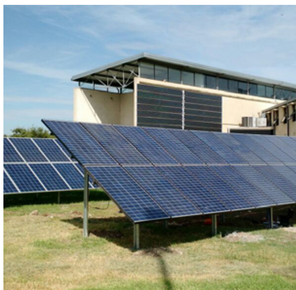
Figura 6: Sistema de paneles solares fotovoltaicos. Fuente: Imagen propia.
