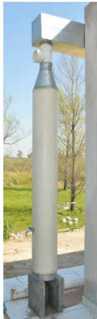
Filtro de primeras aguas instalado
