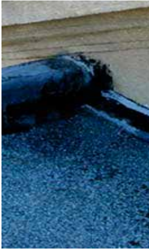
Asbesto en alquitrán
