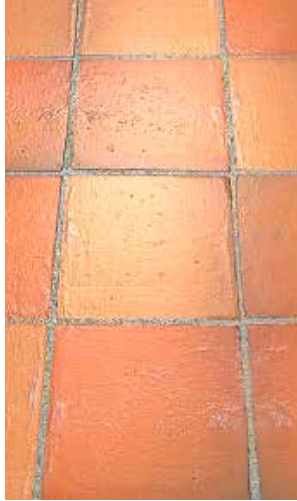
Juntas de dilatación
