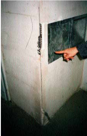
Asbesto en planchas
