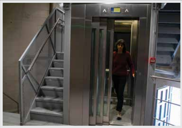
Ascensor. Recientemente inaugurado, permite subir al mirador en menos de un minuto.
