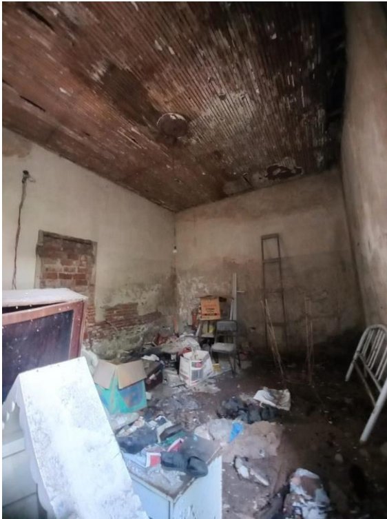
Interior humedad en muros
