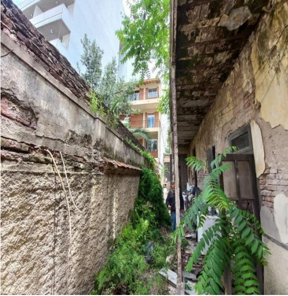
Vegetación en muros
