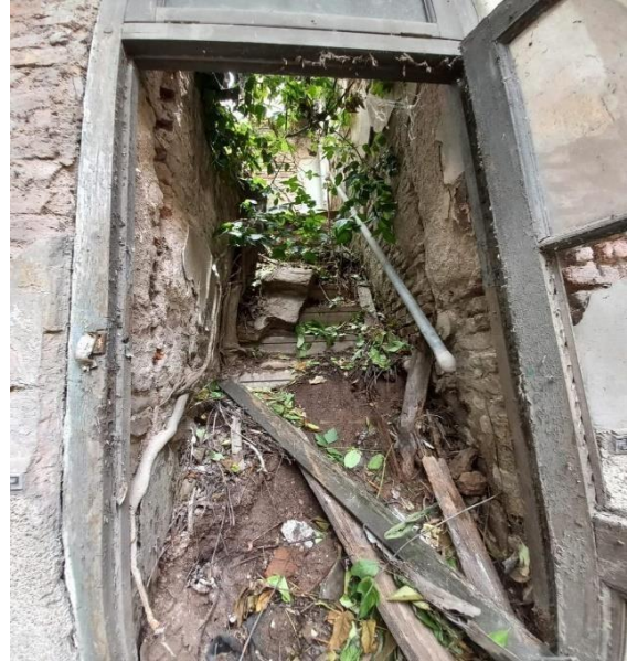
Vegetación crecida en medianera
