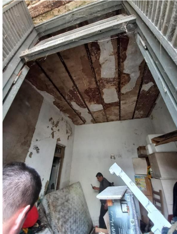
Deterioro estructural bovedilla
