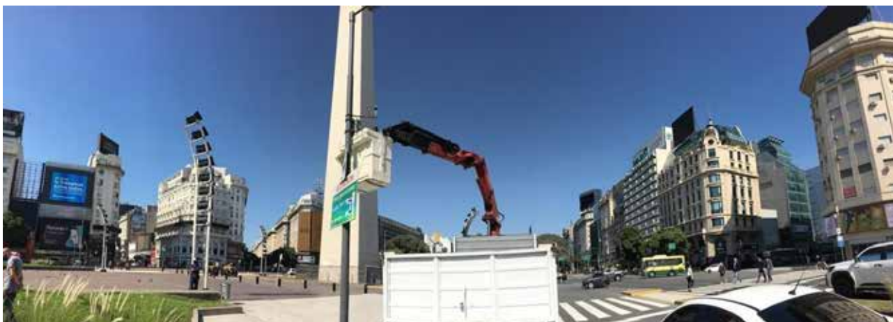
Imagen 2: Instalación de estaciones de monitoreo durante el período 2020.
