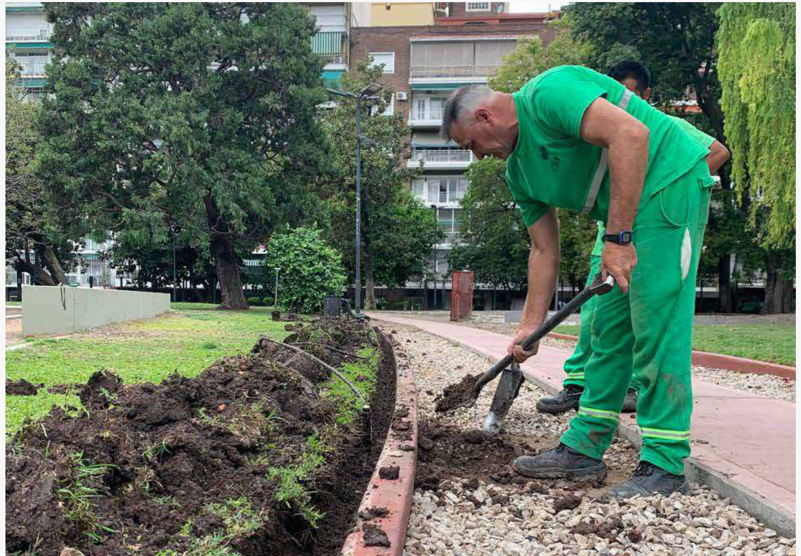
Mantenimiento de sistema de riego (Parque Rivadavia)
