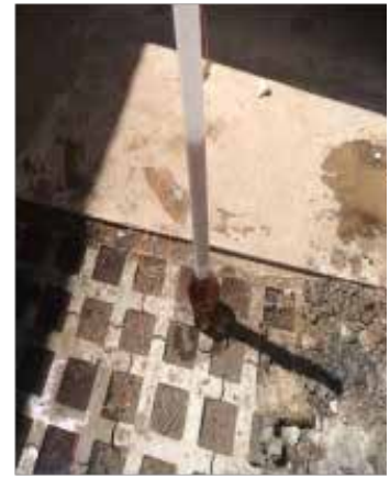
Vistas de agua sucia en las
