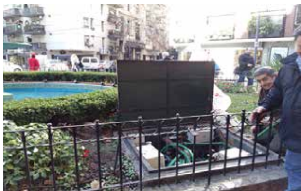
Trabajos en cabina de comando y Tablero.
