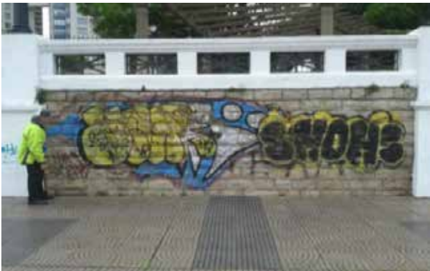
Costanera. Estado inicial en los muros.
